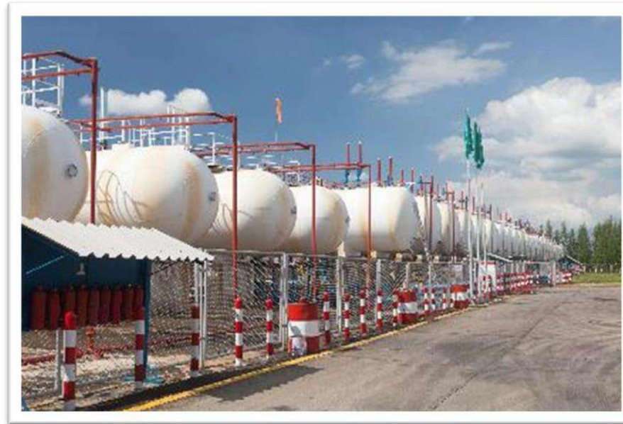
LNG (Liquefied Natural Gas)
